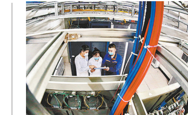
河北秦皇岛无线电管理局工作人员与联通网络维护人员查看机房设备运行和信号发射情况。
