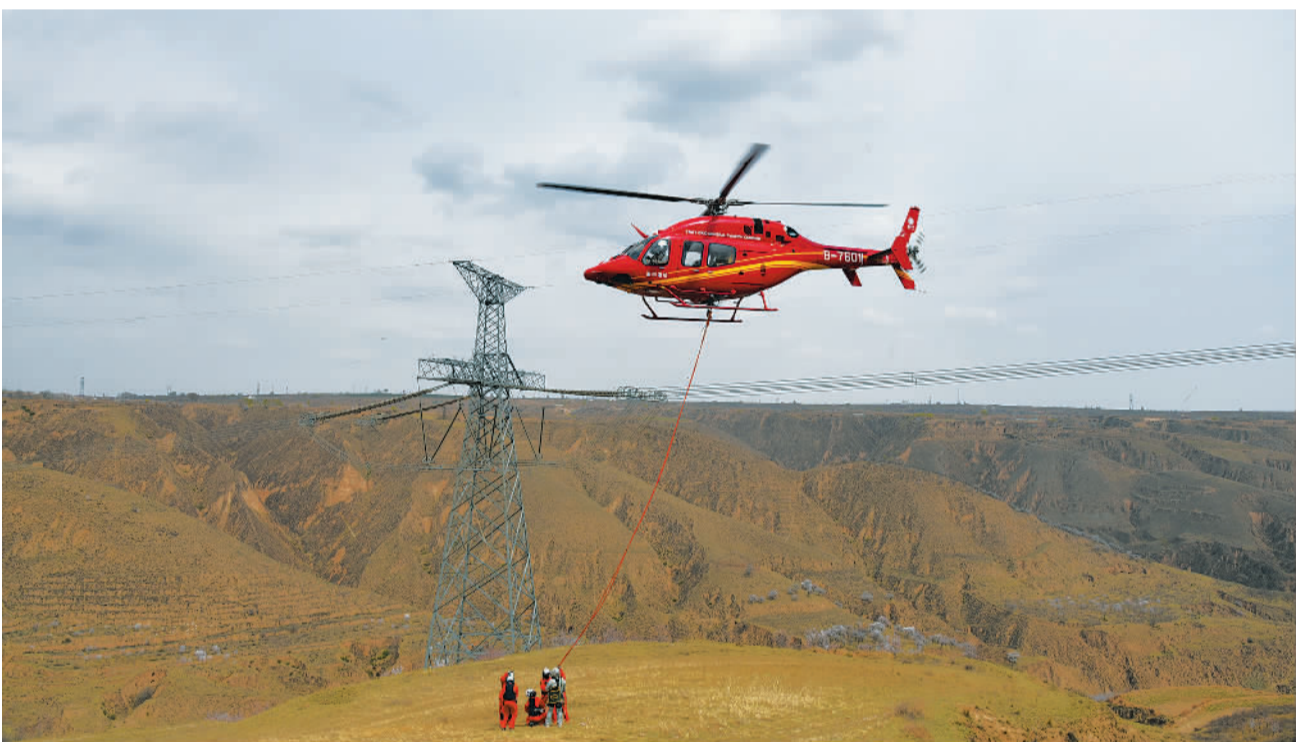
3月31日,甘肃省庆阳市环县,国网甘肃超高压公司开展特高压线路直升机带电作业。国网甘肃电力构建起特高压输电运维保障体系,全年共计划完成特高压直流直升机带电作业66次,可增加外送电能5.93亿千瓦时。
