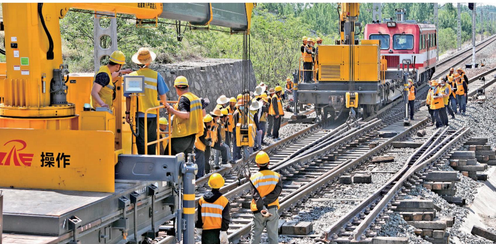
5月17日,中国铁路郑州局集团南阳工务段组织铁路职工对宁西线疏解区道岔中的“可动心”辙叉进行更新施工。暑运即将到来,南阳工务段正在进行道岔更新施工,及时消除安全隐患,确保铁路运力。 张中海摄(中经视觉)
