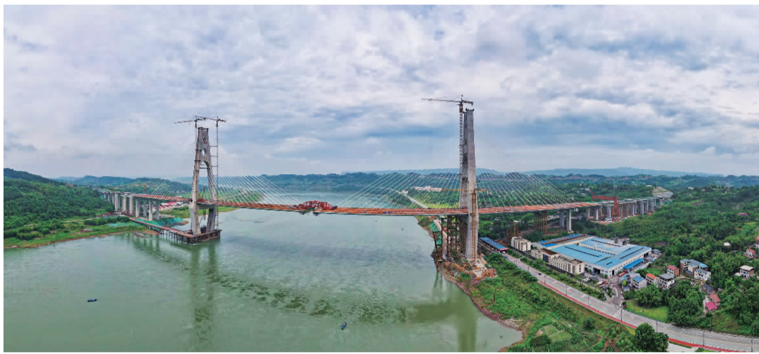
5月22日,航拍即将合龙的宜宾临港长江大桥。按照施工计划,宜宾临港长江大桥将于本月底前合龙。 宜宾临港长江大桥全长1742.1米,主桥标准梁宽63.9米,是国家“八纵八横网”中渝昆高铁、蓉昆高铁经过长江的共同通道。该桥是国内首座高铁与公路平层布置的斜拉桥。 杨 飞摄(中经视觉)
