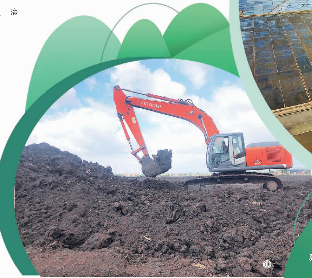
图① 龙煤双鸭山矿业公司的黑土地复垦现场。吴浩摄(中经视觉)
