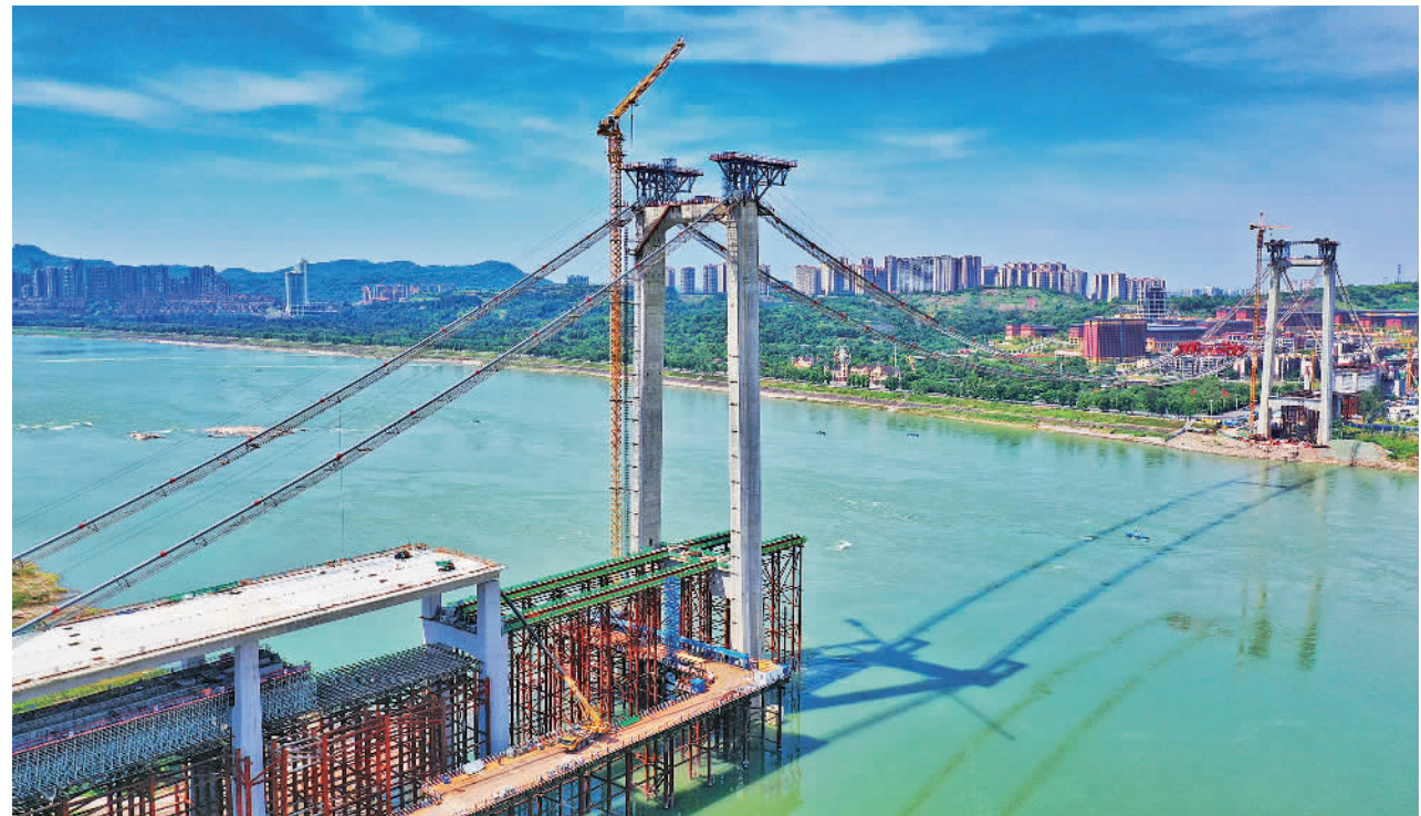
7月12日，位于四川省泸州市的长江二桥施工现场，两根布设主缆宛若“凌空天梯”。该桥为双塔单跨重力式悬索桥，主跨长576米，边跨长216米。大桥建成后，将成为泸州入城的快速通道，促进地区经济社会发展。 杨尚威摄(中经视觉)
