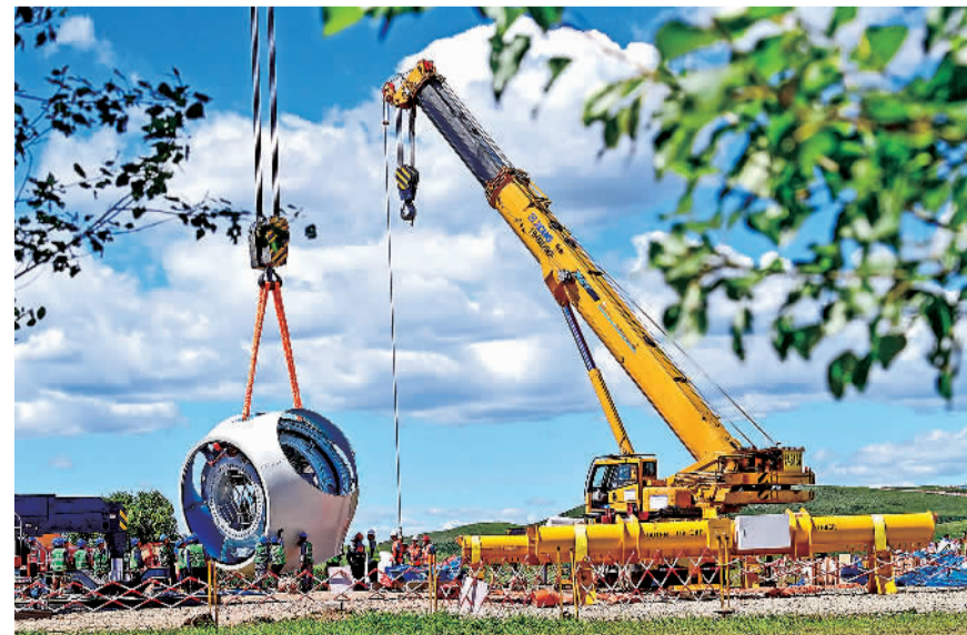
近日,施工人员在华能科尔沁右翼前旗20万千瓦风电项目建设现场吊装风机轮毂。项目单机容量6.25兆瓦,叶片长度为182米的机组发电,标志着目前世界陆上风电单机容量最大、叶片最长的风电机组落户内蒙古兴安盟。王正摄(中经视觉)
