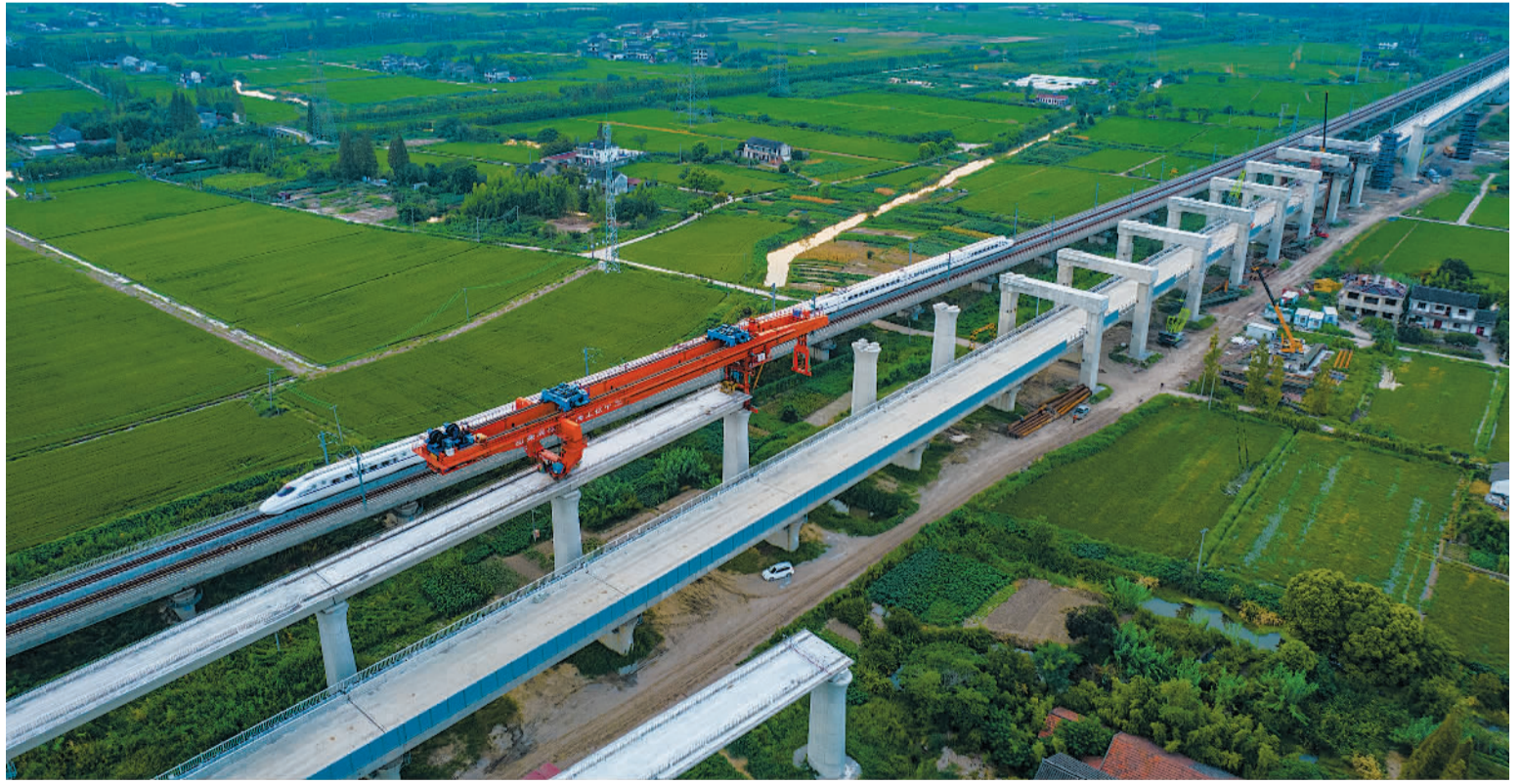
8月19日,由中铁上海工程局承建的江苏南沿江城际铁路I类变更工程施工现场,施工人员在架设预制梁。该铁路是长江经济带综合立体交通走廊规划中的重要组成部分,正线长度约278公里,今年底将完成主体工程建设,预计明年开通运营。(中经视觉)
