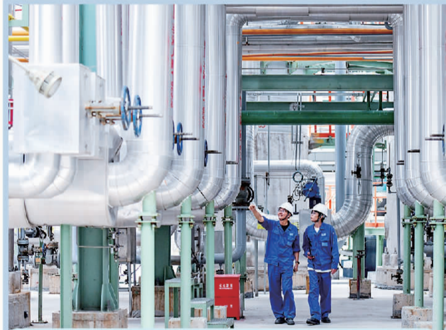
宁波博汇化工科技股份有限公司工作人员在制氢区域巡查自动控制系统运行情况。 本报记者 郁进东摄
