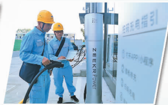
南方电网广东东莞城区供电局为大广汽国际项目新增的3000千伏安变压器接入送电，此项目是东莞市重大项目、大湾区新型新能源汽车产业中心
