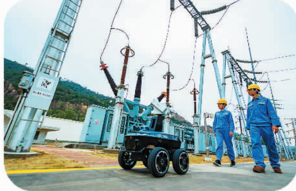
2020年12月10日,南方电网广东珠海供电局以“人巡+机巡”的模式,对220千伏琴韵变电站内对澳门供电线路开展巡检
