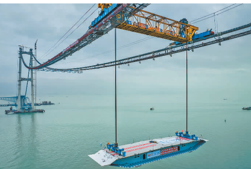
1月12日，世界最高海中大桥深中通道伶仃洋大桥首榀箱梁成功吊装，标志着大桥建设进入上部结构安装新阶段。深中通道预计2024年通车，将有力推进珠三角经济、交通一体化，届时深圳到中山车程将由2小时缩减至20分钟。苏振飞摄（中经视觉）
