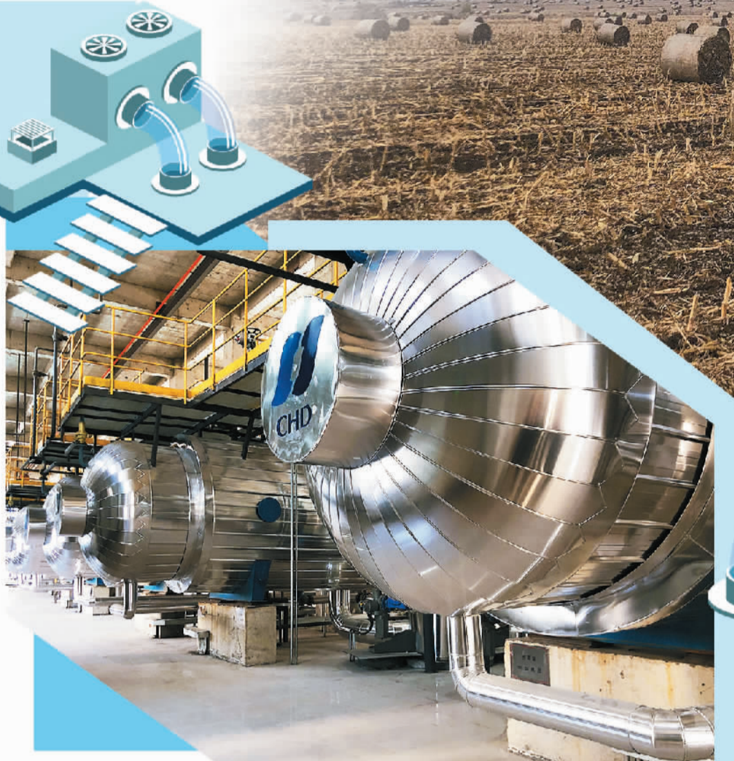
图为华电能源股份有限公司富拉尔基发电厂内的供热首站。
