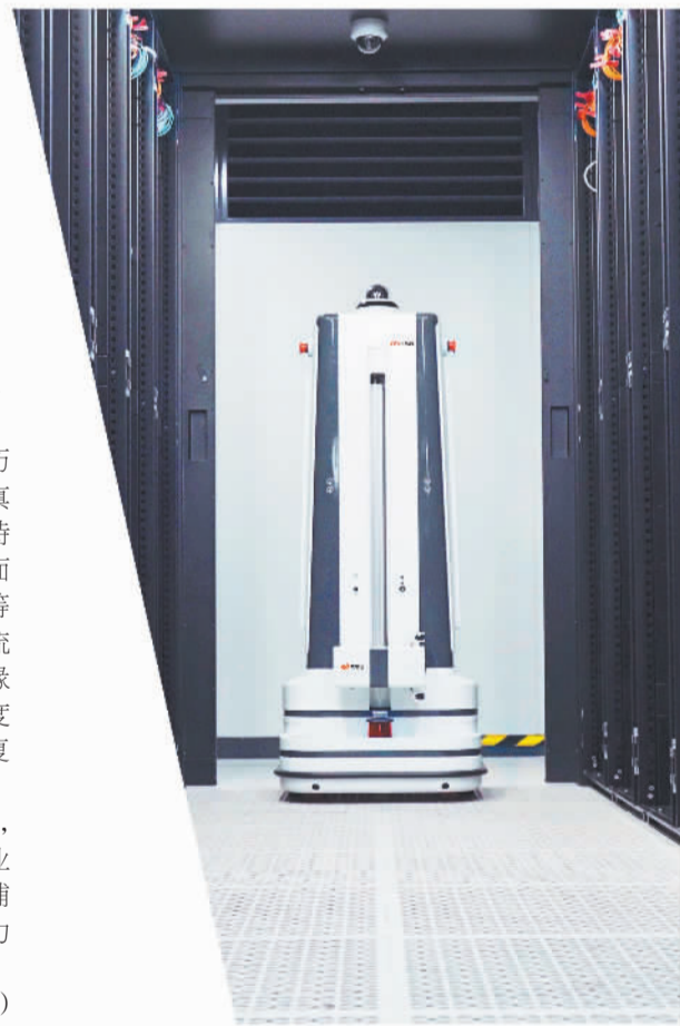
京东云数据中心智能巡检机器人在工作
