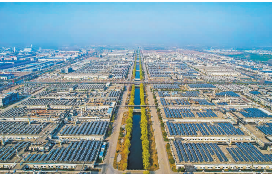
日前，江苏省宿迁市苏宿工业园区屋顶分布式光伏发电站，一排排光伏发电设备正在运行。近年来，苏宿工业园区加大企业屋顶光伏发电站的建设力度，发展清洁能源。 陈少帅摄（中经视觉）
