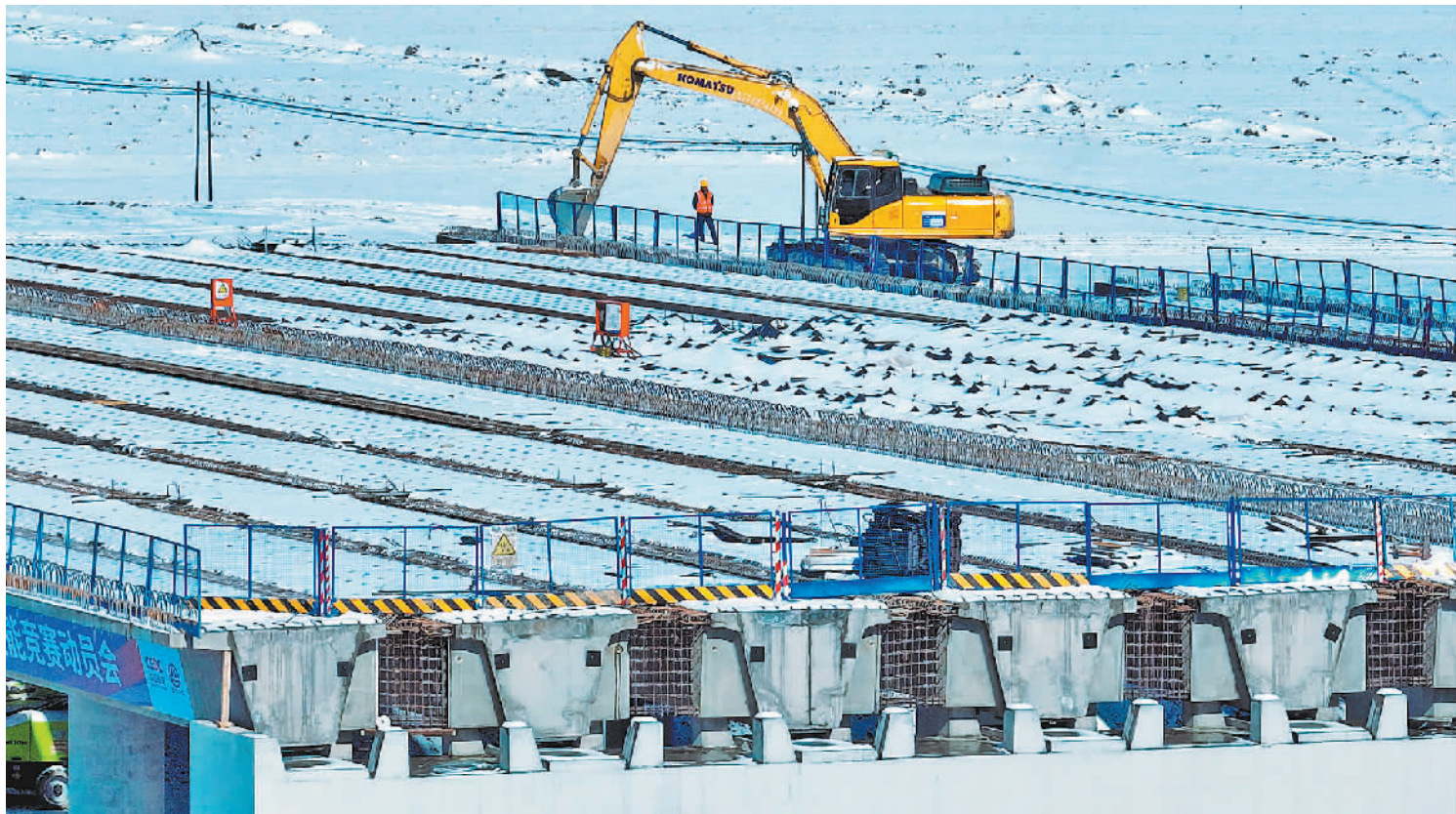
3月20日，乌鲁木齐绕城高速(西线)工程施工现场，工人正抢抓工期，推进工程建设。该工程是国家高速公路规划网重点项目之一，全长93.616公里，于2021年开工，计划明年建成。王建锋摄(中经视觉)
