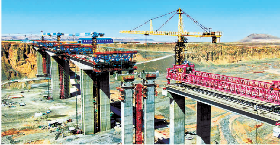
3月25日，新疆昌吉呼图壁县境内的昌吉州西部南山伴行公路项目（一期）呼图壁大桥施工现场。该项目（一期）线路全长69公里，总投资19.98亿元，建成后不仅可以丰富当地公路路网结构，还将对当地旅游和经济发展起到巨大推动作用。陶维明摄（中经视觉）
