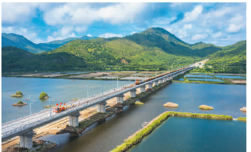
6月6日,广东省汕尾市大化村隧道出口施工现场,汕(尾)汕(头)高铁开始全线铺轨,正式进入开通前的冲刺阶段。建成通车后,广州至汕头时间将缩短至1.5小时左右。彭特摄(中经视觉)
