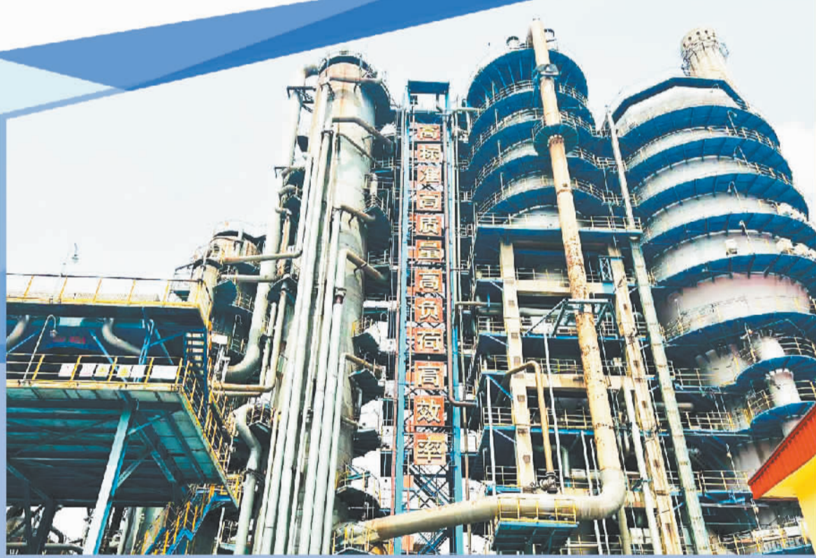
吉林石化炼油厂催化裂化装置。 本报记者 马洪超摄
