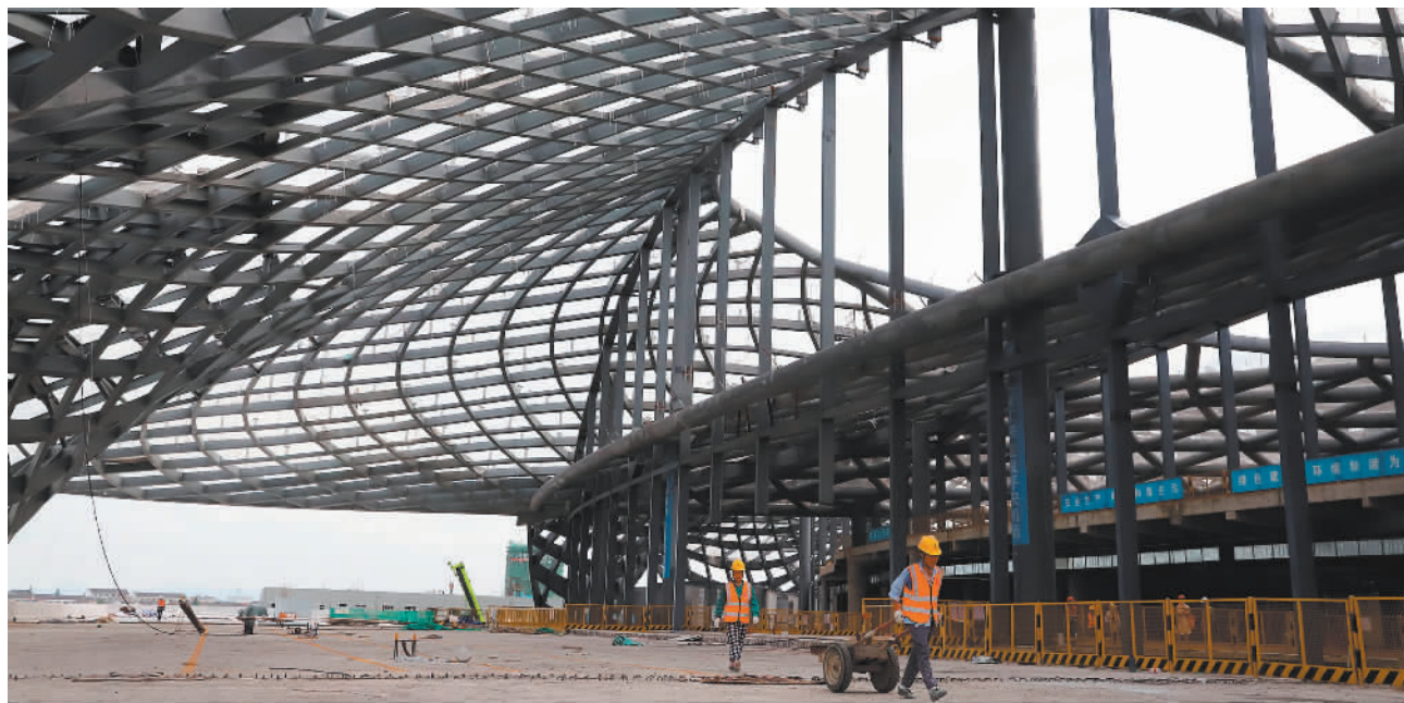
7月13日,浙江省台州市路桥机场改扩建项目施工现场,工人战高温赶进度。该项目是浙江省重点建设项目,总投资约35.88亿元。项目将新建1条长2500米的平行滑行道及端联络道等滑行道系统,16个机位的站坪及飞行区附属设施,3.5万平方米的航站楼以及综合楼、货运站、停车库、航管楼、塔台等配套设施。蒋友青摄(中经视觉)
