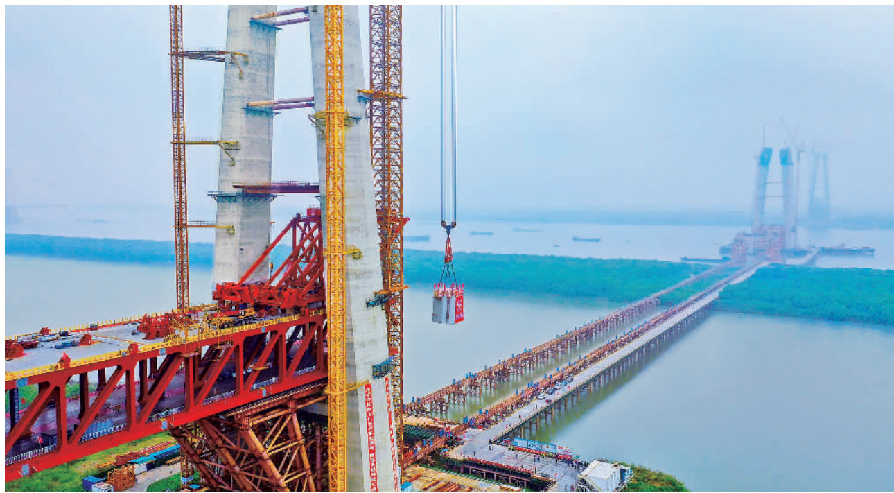
8月14日,由中国中铁工业中铁九桥工程有限公司承建的世界最大跨度三塔斜拉桥——巢马城际铁路马鞍山长江公铁大桥3号主塔顺利封顶。马鞍山长江公铁大桥是巢马城际铁路的控制性工程,双跨连续跨度2240米,为世界上首座双主跨超千米的三塔斜拉桥,同时也是世界上最长联钢桁梁斜拉桥。熊红梅摄(中经视觉)
