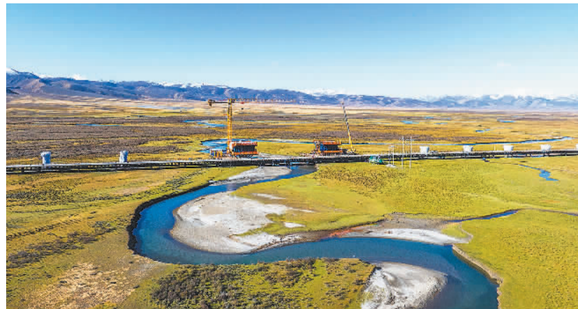
四川省甘孜藏族自治州理塘县318国道旁，川藏铁路康定(新都桥)至林芝段正在建设中。川藏铁路东起成都，西至拉萨，是我国第二条进藏铁路，也是西南地区的干线铁路之一。该铁路建成通车后，将有效加强川藏两地联系，带动沿线地区经济社会发展。
