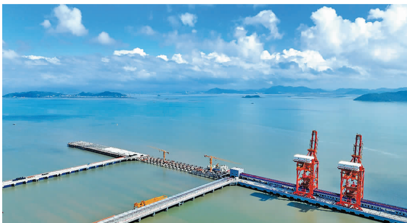
11月5日,浙江省温州市乐清湾港区通用作业区(C区)一期工程加速推进,3个10万吨级泊位工程项目及配套栈桥桩基施工全部完工。项目建成投产后,主要用于煤炭、钢材、粮油等货物装卸,将助力乐清湾港区成为浙南地区大宗散货中转基地,进一步提升温州港的区位优势 and 综合竞争力。 蔡宽元摄(中经视觉)
