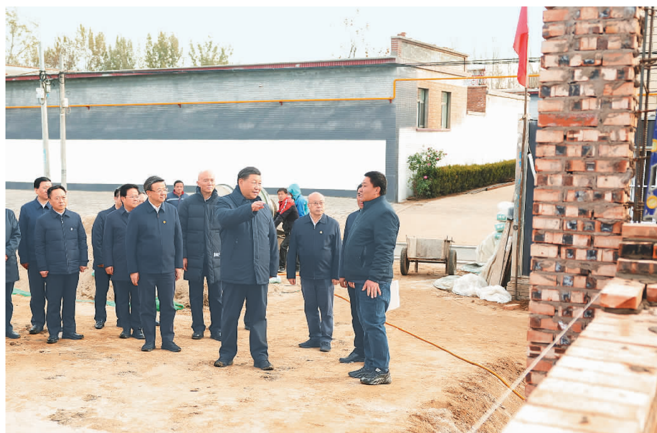
11月10日,中共中央总书记、国家主席、中央军委主席习近平在北京、河北考察灾后恢复重建工作。这是10日下午,习近平在河北保定涿州市刁窝镇万全庄村房屋重建施工现场考察。
