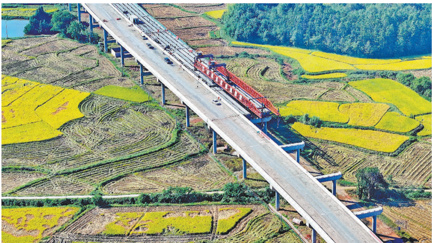
11月21日,位于江西省抚州市东乡区的东临环城高速公路桥梁正在架设。项目通车后,将加快区域交通互联互通,更好满足群众便捷出行需求,助力当地融入长三角、珠三角等区域经济发展。 朱海鹏摄(中经视觉)
