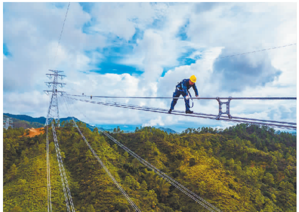
南方电网深圳供电局工作人员在输电线路走线巡视
