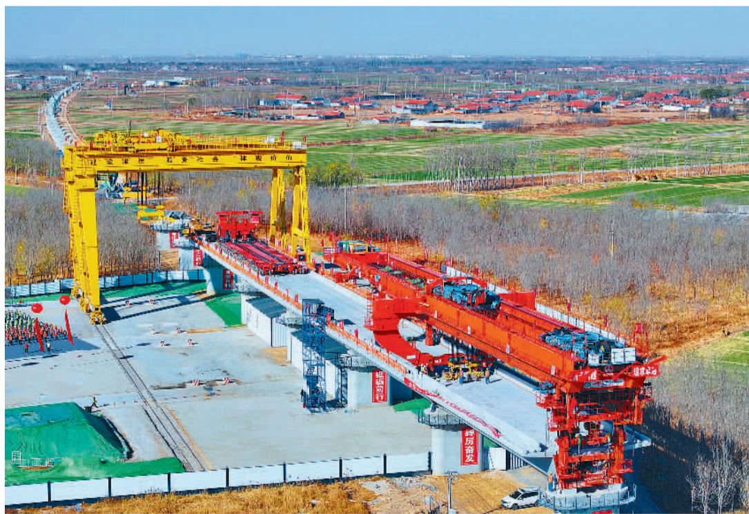
11月23日，在山东省东营市利津县，津潍高铁全线首榀箱梁成功架设，项目施工进度顺利。津潍高铁是国家“八纵八横”干线高铁网、沿海通道、沿黄达海通道的重要组成部分。项目建成后，将结束东营、滨州不通高铁的历史。周广学摄(中经视觉)
