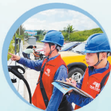
贵州电网六盘水供电局工作人员开展景区充电桩检查
