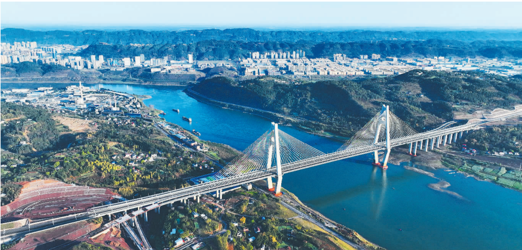
3月25日,四川省宜宾市,渝昆高铁宜宾临港长江大桥南、北连接线路项目正在建设中。渝昆高铁重庆至宜宾段计划于今年年底建成通车,届时宜宾、泸州至重庆的行车时间将缩短至1小时内。
