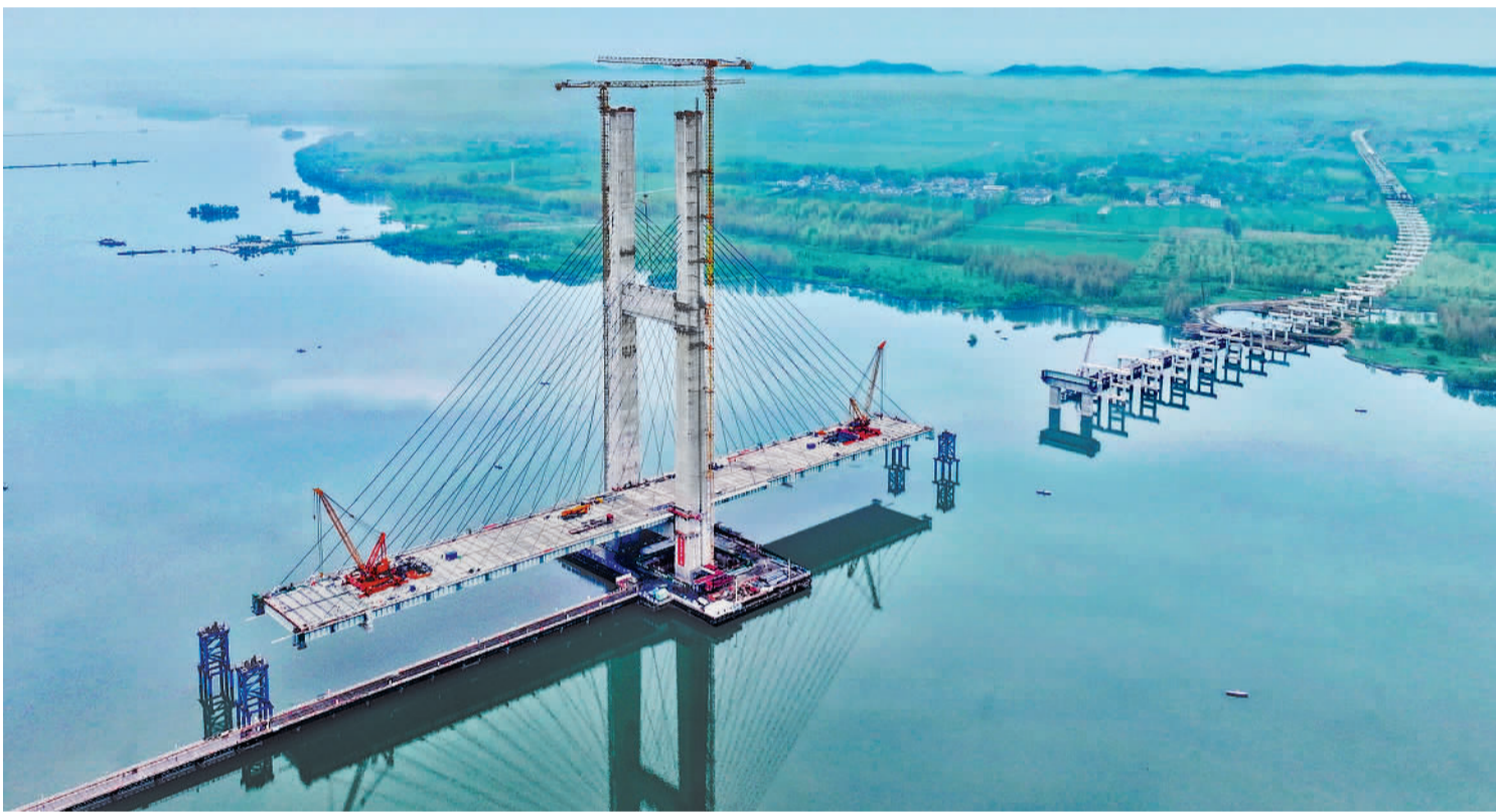
4月7日，湖北襄阳，中交二航局施工人员正在牛首汉江特大桥安装斜拉索。该桥建成后将是国内最大跨径组合梁独塔斜拉桥，有望提升国道通行能力和路网整体运营效率。谢勇摄(中经视觉)
