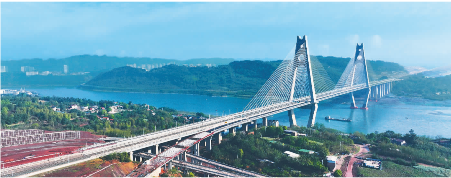
4月8日,四川省宜宾市叙州区,渝昆高铁宜宾临港长江大桥南连接线工程加紧施工。该项目建成后,将贯通宜宾“二纵三横”线,完善区域路网结构,有效分流过境交通。 兰 锋摄(中经视觉)
