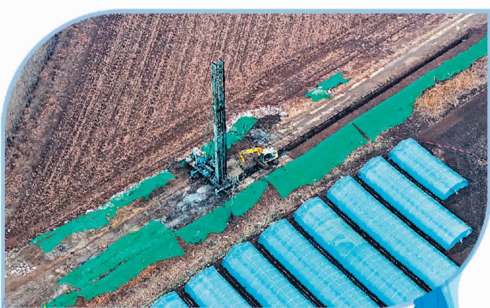
近日，天津市静海区台头北固堤加固工程开始施工，以提升抵御洪水能力，工程预计6月完工。新华社记者 赵子硕摄
