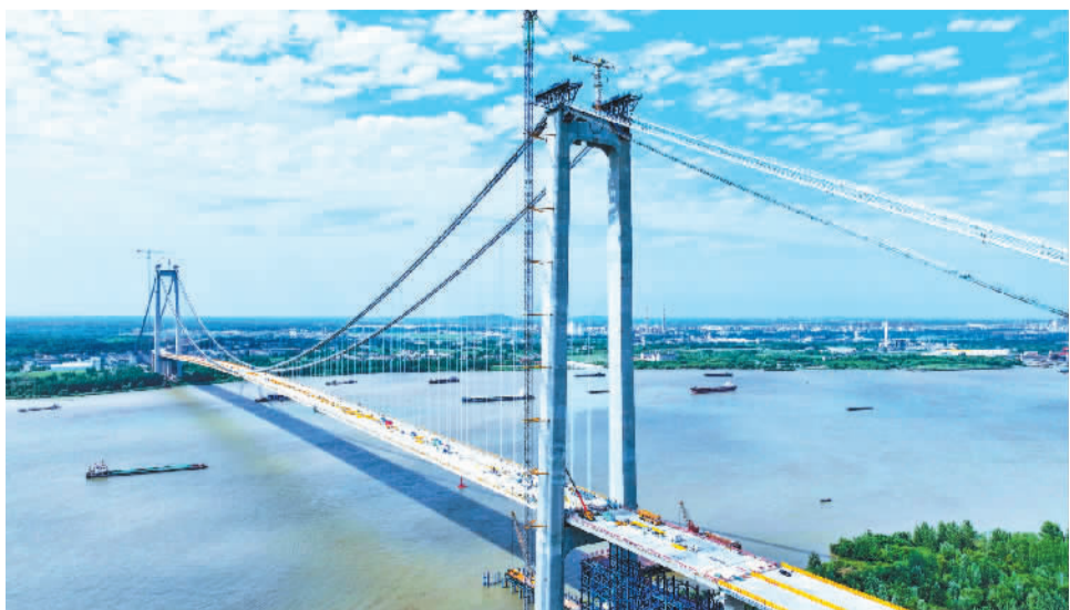
近日,位于江苏省境内的龙潭长江大桥工程项目开始猫道拆除工作,标志着项目建设进入冲刺阶段。该大桥连接南京、扬州两市,全长约5.8公里。大桥建成后将对推动扬子江城市群建设、宁镇扬一体化发展具有重要意义。 方东旭摄(中经视觉)
