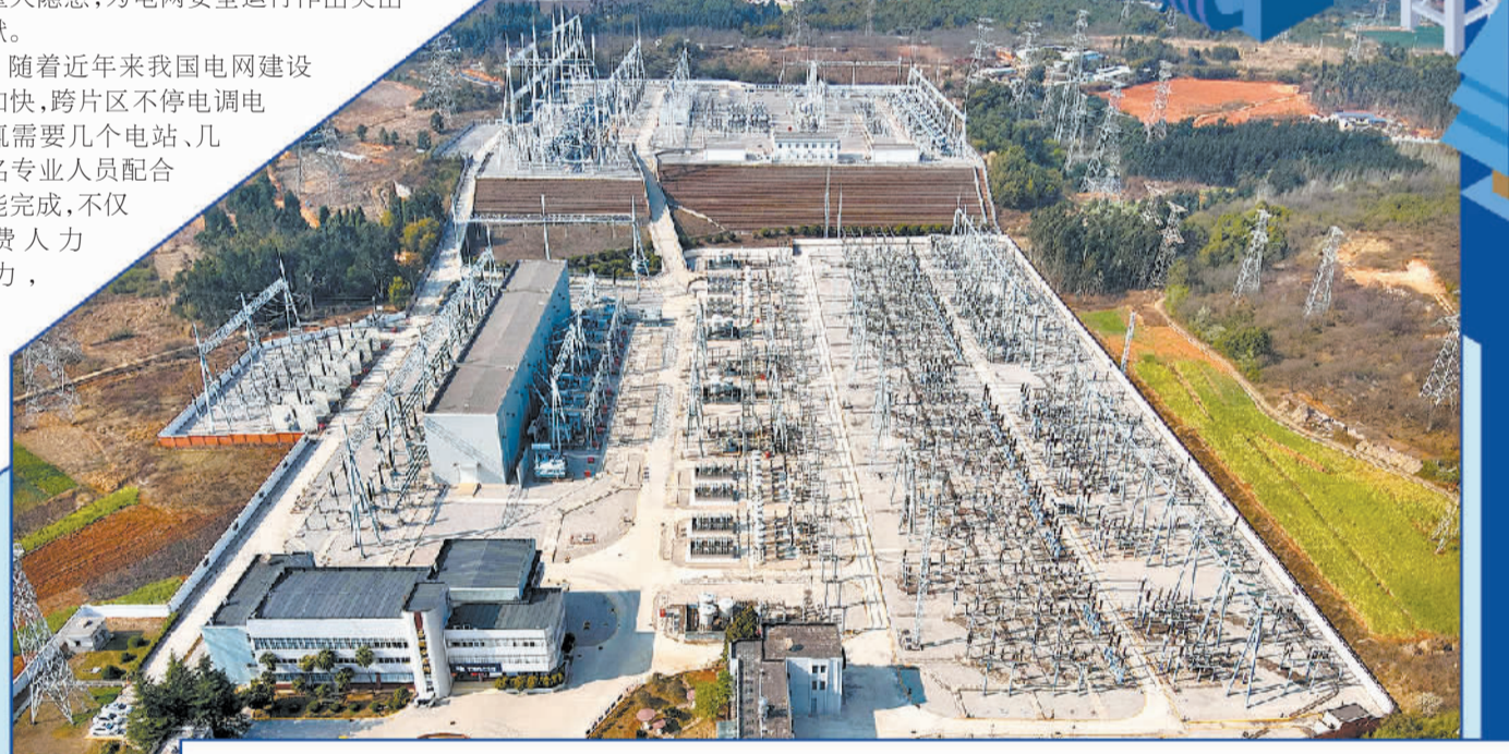
位于昆明的草铺变电站是云南省“西电东送”的重要枢纽。李辉曾带领团队对草铺变电站进行改造,保障电网的安全稳定运行。 张半翔摄(中经视觉)
