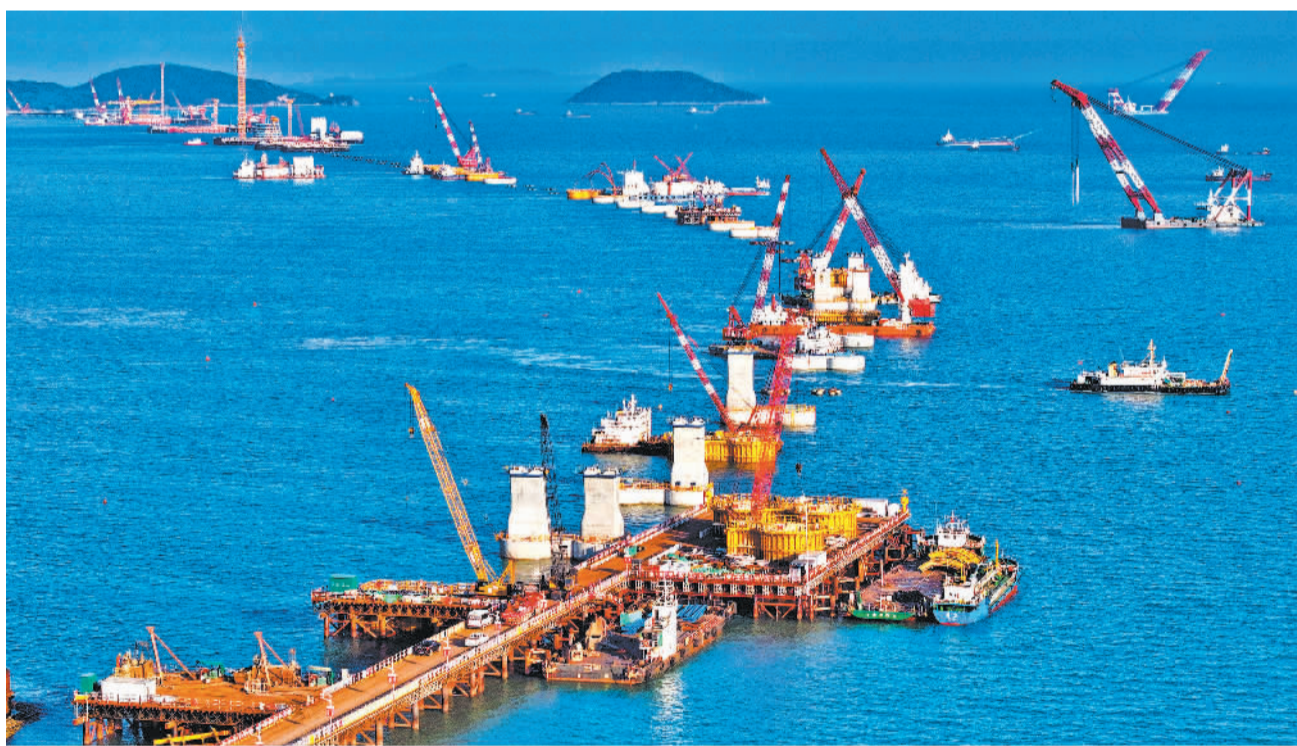
8月14日，浙江省宁波舟山港六横公路大桥二期项目工程正在建设中。大桥建成后，六横岛、佛渡岛、梅山岛三岛可实现港区、产业等联动，对推动甬舟一体化发展具有重要意义。 胡学军摄(中经视觉)
