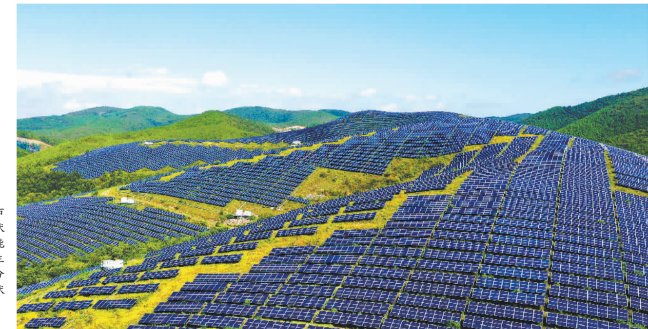
日前,在安徽省巢湖市柘皋镇汪桥村后山上,光伏发电设施不断输送着绿色能源。近年来,巢湖市坚持生态优先、绿色发展理念,充分利用荒山、坡地等发展光伏产业。 马丰成摄(中经视觉)
