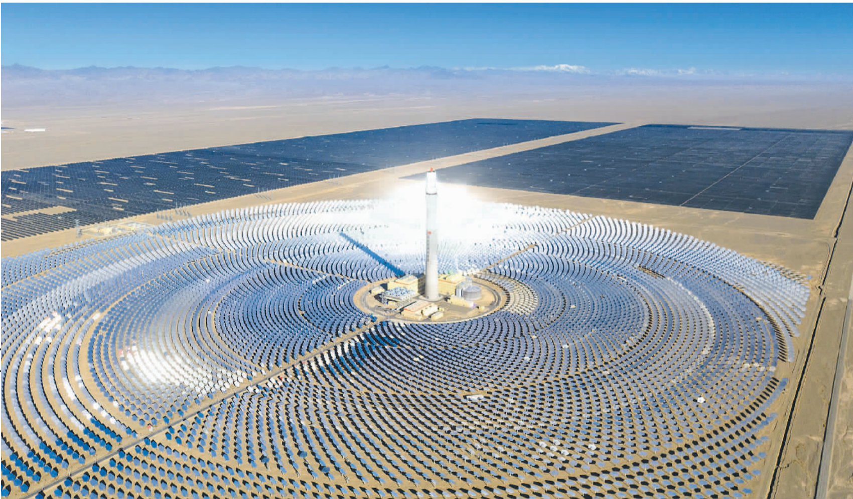
11月30日,甘肃省酒泉市阿克塞哈萨克族自治县四十里戈壁千万千瓦级太阳能热发电基地内,阿克塞汇东新能源光热+光伏示范项目光热部分并网发电,这是继光伏部分并网后,项目建设取得的又一重大进展,标志着国内在建单机规模最大的塔式光热发电项目实现全容量并网发电。(中建数摄(中经视觉))
