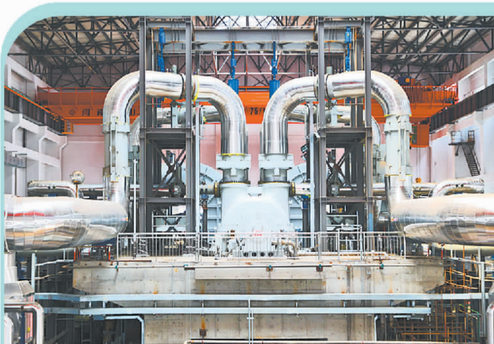
山东省肥城市300MW先进压缩空气储能国家示范电站主厂房。(资料图片)
