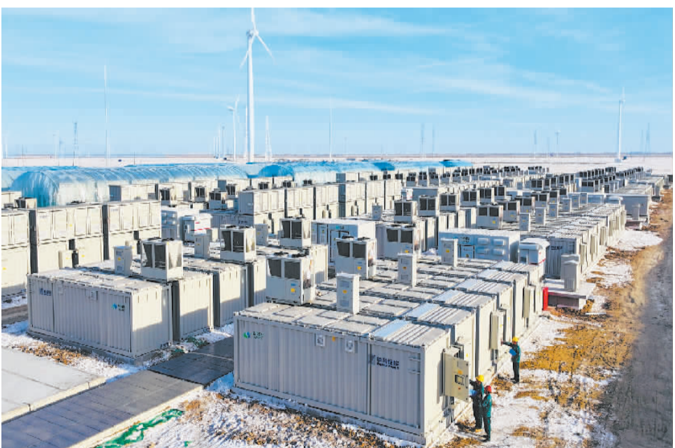
近日，严寒地区全国首套大型全钒液流电池共享储能电站、东北地区首座集中共享式储能电站——吉林松原乾安中开玉宇储能电站正式投产。该电站投产后，将有效缓解当地新能源发电的间歇性和波动性问题，提升电网的调节能力和稳定性，增强电网对新能源的接纳能力。图为在松原乾安中开玉宇储能电站，工作人员在检查电力运行状况。
