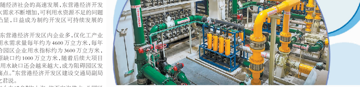
图为东营港经济开发区纳海水务发展有限责任公司的生产车间。（资料图片）
