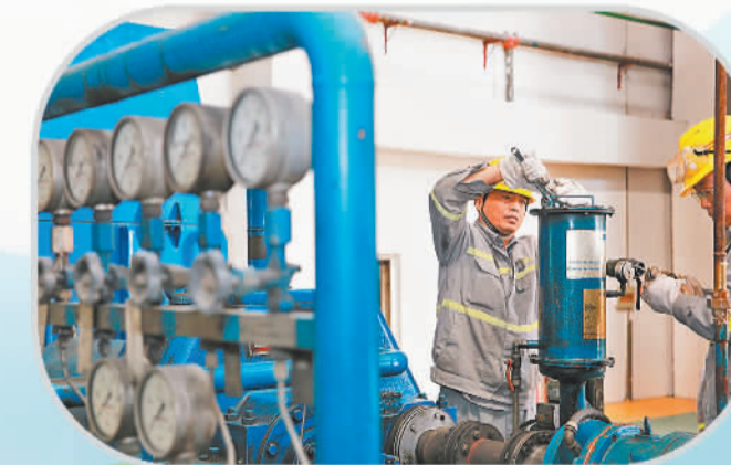
在铜陵有色金冠铜业分公司，技术人员正在对余热蒸汽发电设备进行检查维护
