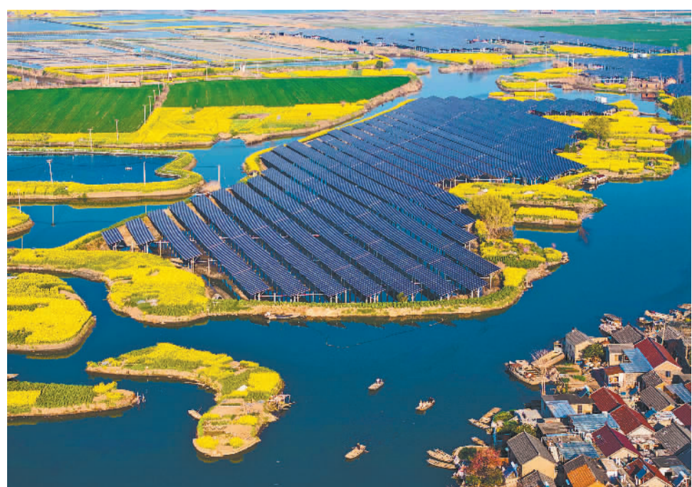
3月26日，江苏省泰州市海陵区下溪村渔光互补光伏发电项目被美丽的春光包裹。近年来，海陵区华港镇有序发展渔光互补和风力发电等清洁能源产业，助推经济绿色低碳发展。汤德宏摄(中经视觉)
