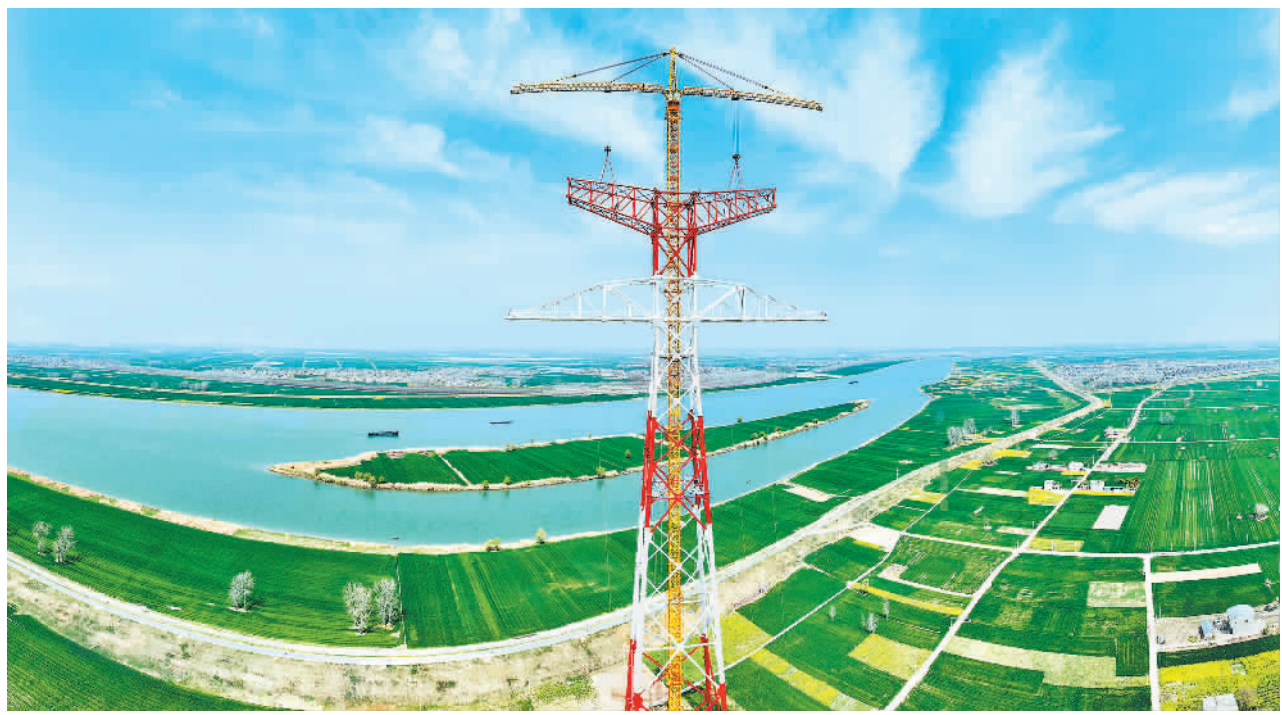
4月1日,安徽香涧至鹭岛500千伏线路工程淮河大跨越193米的南岸跨越塔成功封顶。香涧至鹭岛500千伏线路工程建成后,将提高相关地区供电可靠性和新能源消纳能力。新华社记者 杜宇摄
