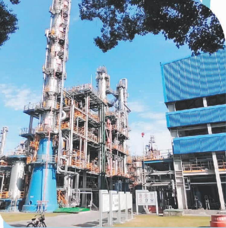
镇海炼化年产10万吨生物航煤装置。
