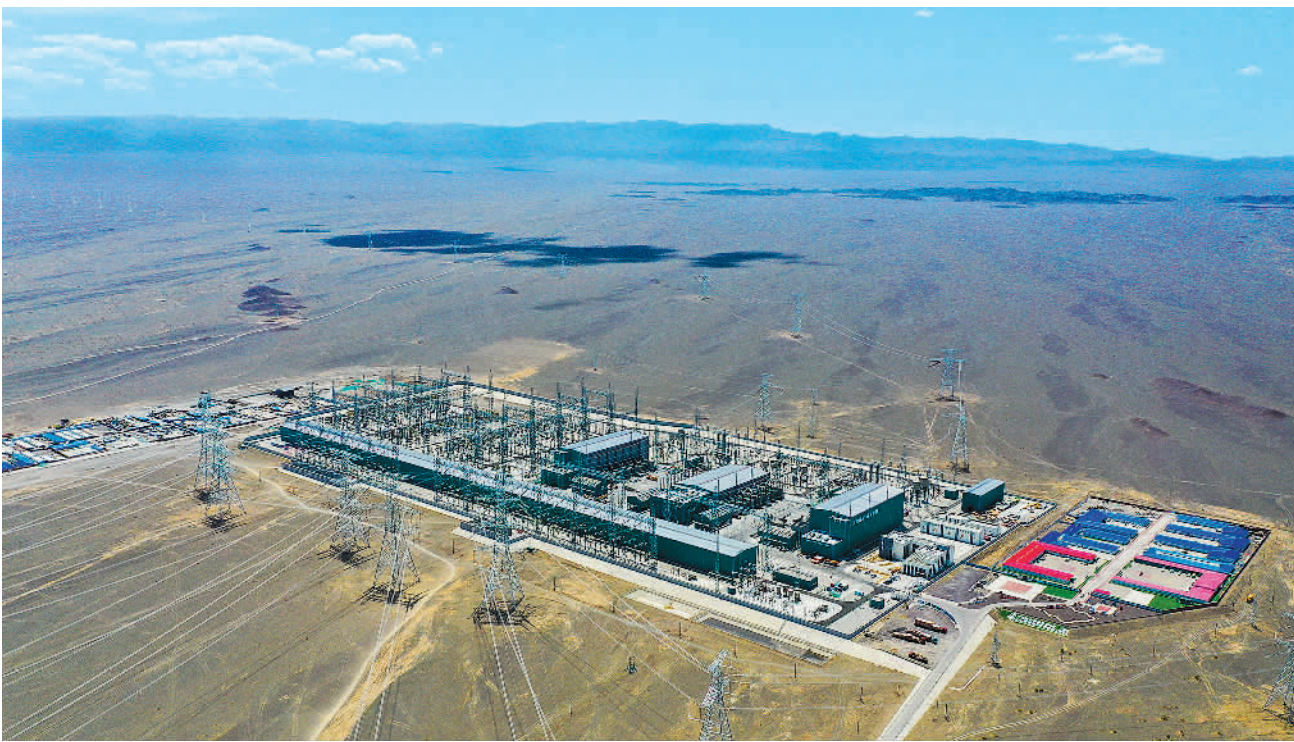
国家电网6月10日宣布,哈密—重庆±800千伏特高压直流输电工程(哈密—重庆工程)投产送电。作为我国第3条“疆电外送”直流动脉,承载着将西北的清洁能源向巴山渝水输送的使命。这是10日拍摄的哈密—重庆±800千伏特高压直流输电工程新疆送端站——巴里坤换流站。
