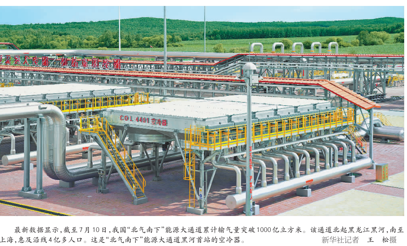
最新数据显示，截至7月10日，我国“北气南下”能源大通道累计输气量突破1000亿立方米。该通道北起黑龙江黑河，南至上海，惠及沿线4亿多人口。这是“北气南下”能源大通道黑河首站的空冷器。 新华社记者 王 松摄
