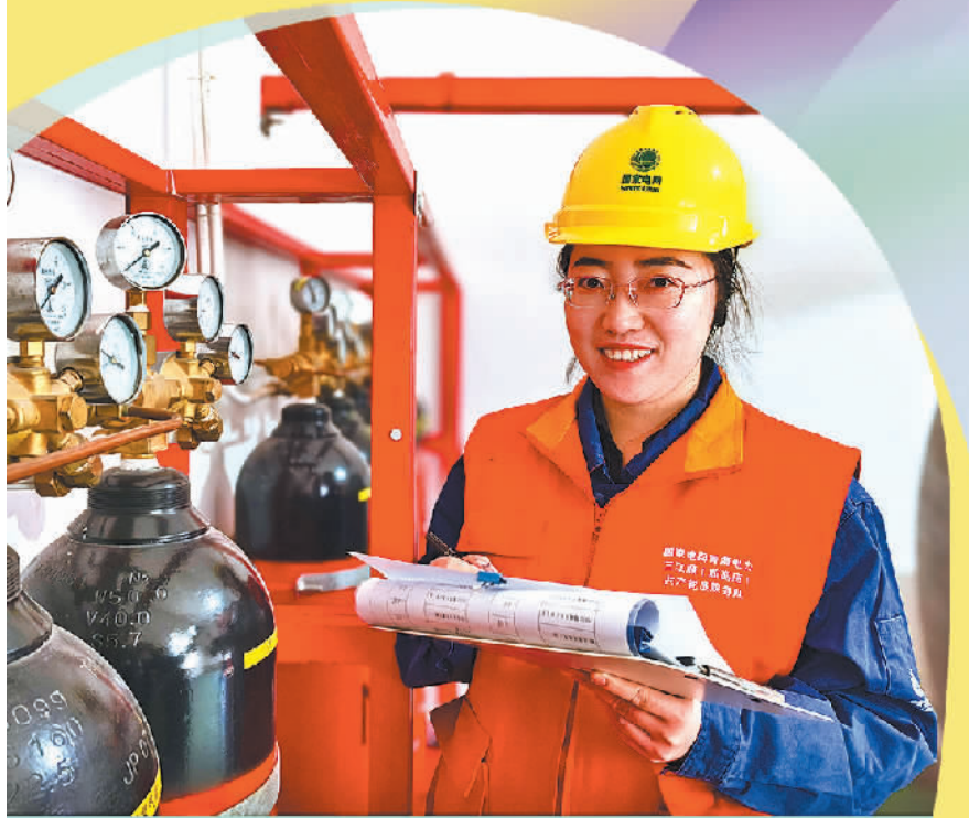
吴嘉楠在西宁 750 千伏变电站开展设备巡视。（资料图片）
