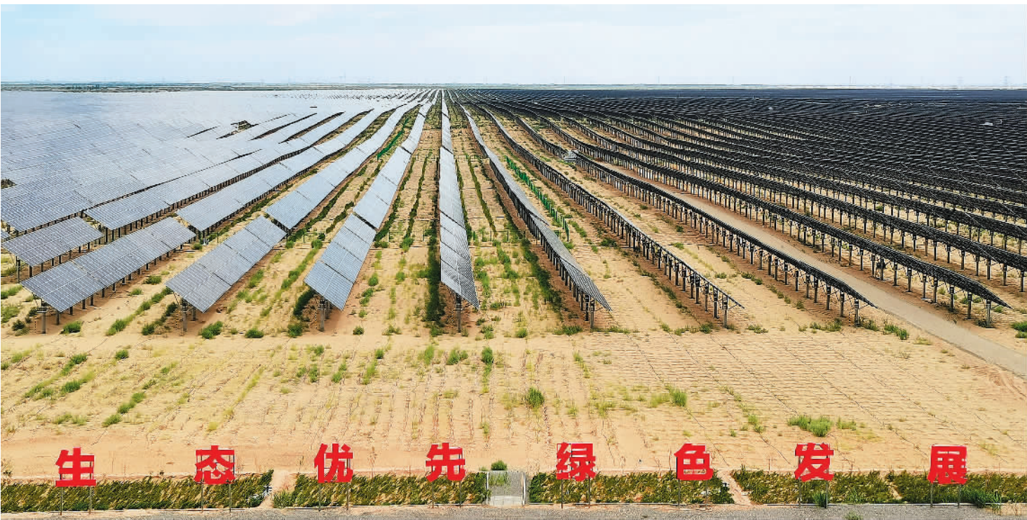
内蒙古自治区巴彦淖尔市磴口县光伏+生态治理项目位于乌兰布和沙漠腹地,是国家和内蒙古自治区重点打造的新能源基地之一,通过“板上发电、板下种植”实现了光伏产业和生态治理的有机结合。图为8月5日拍摄的内蒙古能源集团磴口县160万千瓦光伏+生态治理项目。
