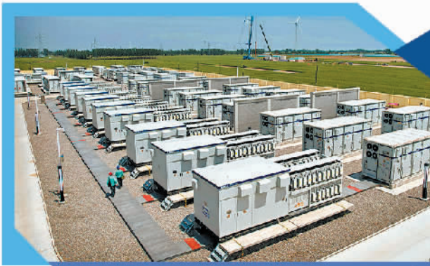
国网故城县供电公司的工人在军屯镇牛庄村附近的储能电站巡检。 新华社记者 杨世尧摄
