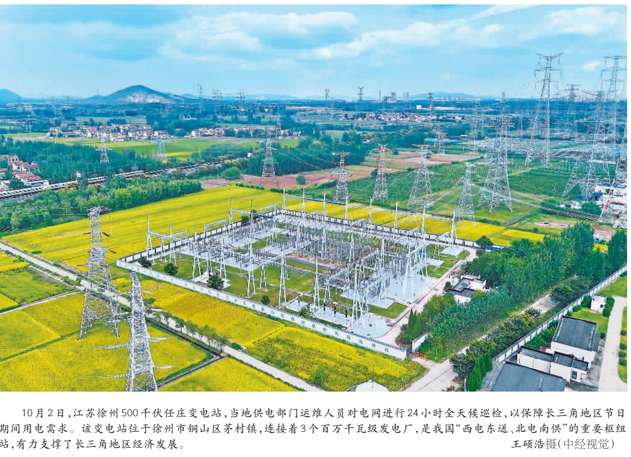
10月2日，江苏徐州500千伏任庄变电站，当地供电部门运维人员对电网进行24小时全天候巡检，以保障长三角地区节日期间用电需求。该变电站位于徐州市铜山区茅村镇，连接着3个百万千瓦级发电厂，是我国“西电东送、北电南供”的重要枢纽站，有力支撑了长三角地区经济发展。 王硕浩摄（中经视觉）
